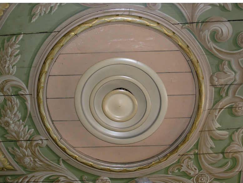
Afb. 4. Detail van het huidige plafond met één van de uitstroom-openingen (de drie glimmende ronde structuren) van de luchtverwarmingsinstallatie. De ruimte rondom deze opening binnen de vergulde lijst is ca. 1960 dichtgemaakt met planken. Ter weerszijden van de vergulde lijst is te zien dat de plafondplanken oorspronkelijk ononderbroken achter de lijst hebben doorgelopen. De ronde uitsparingen in de planken zijn in 1879 aangebracht bij de aanleg van een ventilatiesysteem. (Foto: BAM)
