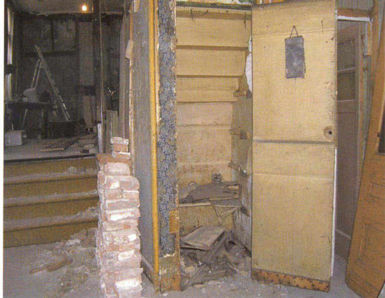
De kast onder de trap waarin verschillende catalogusboeken uit de jaren 1920-30 werden aangetroffen. Doordat de planken waren ingezakt lagen de boeken als een hoopje op de grond. (Foto: BAM)
